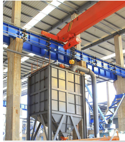
CẦU TRỤC CHẠY TRÊN TOP RUNNING
